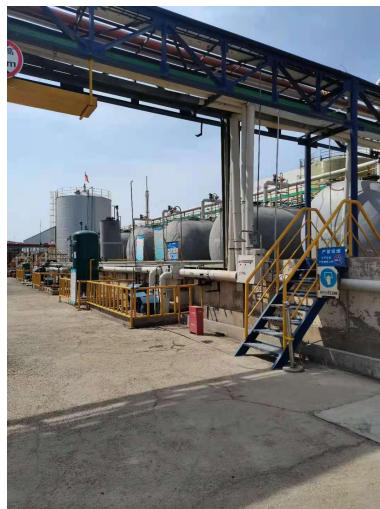
4、二甲液体罐区
